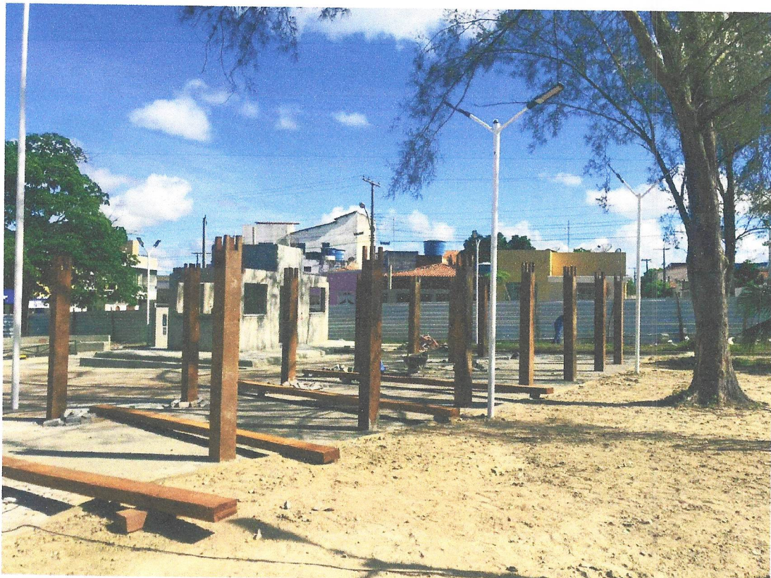
Foto 14 – Madeiramento em massaranduba para telhado, peça principal serrada 20cm x20cm, com abertura de encaixes
