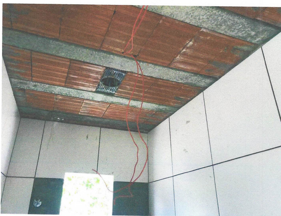
Foto 06- CAIXA OCTOGONAL 4" X 4", PVC, INSTALADA EM LAJE - FORNECIMENTO E INSTALAÇÃO. AF_12/2015
