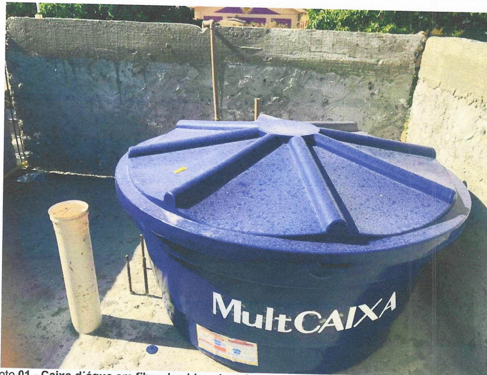
Foto 01 - Caixa d'água em fibra de vidro - instalada, sem estrutura de suporte, cap. 500 litros
